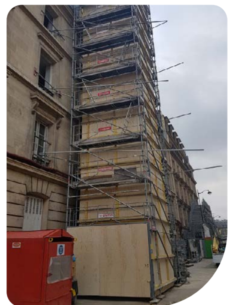
Palissade en Contreplaqué extérieur Pour la protection d'un transformateur électrique
